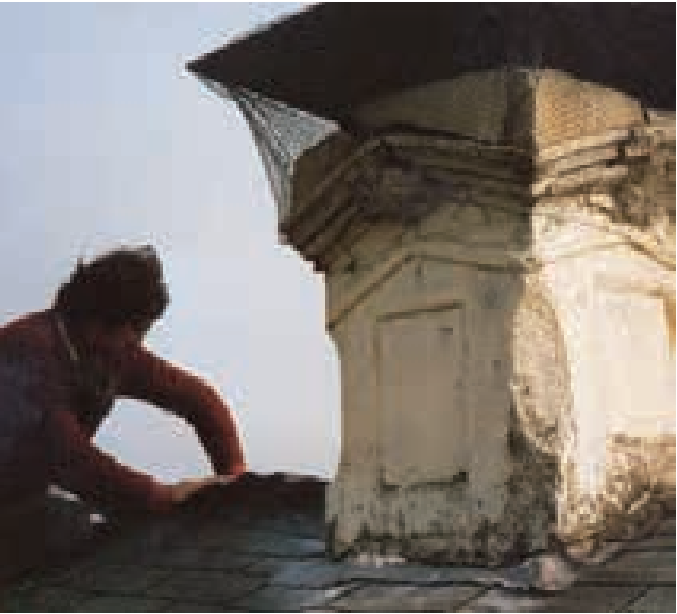
Het dak was zo lek als een zeef en regelmatig moest Pieter Battjes het dak op om de dakbedekking op zijn plaats te schuiven.
